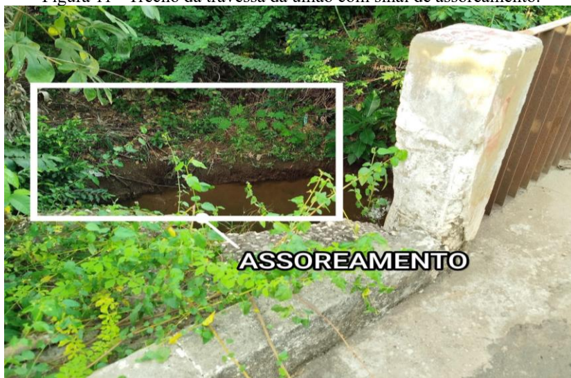
Figura 11 - Trecho da travessa da união com sinais de assoreamento.
