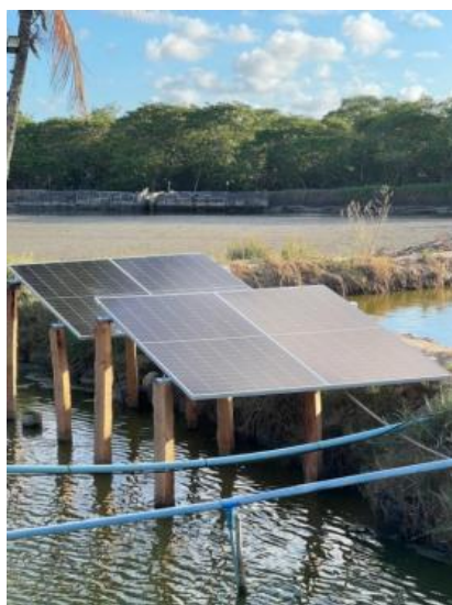
Figura 4. Arranjo dos módulos fotovoltaicos monocristalinos instalados na margem do viveiro de camarão em Nossa Senhora do Socorro (SE).
