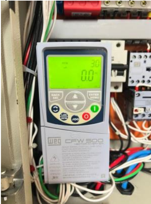
Figura 7. Inversor de frequência WEG CFW500 instalado no quadro de comando e proteção.
