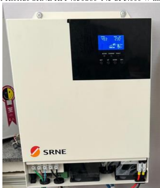
Figura 5. Inversor Híbrido SRNE HFP4850S80-145 de 5.000 W instalado no sistema.
