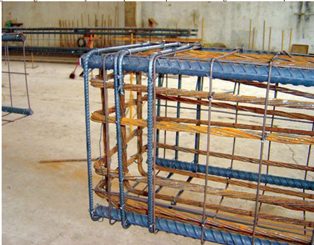
Figura 4 – A gaiola de Faraday é formada pela enorme quantidade de ferragens das estruturas pré-moldadas
